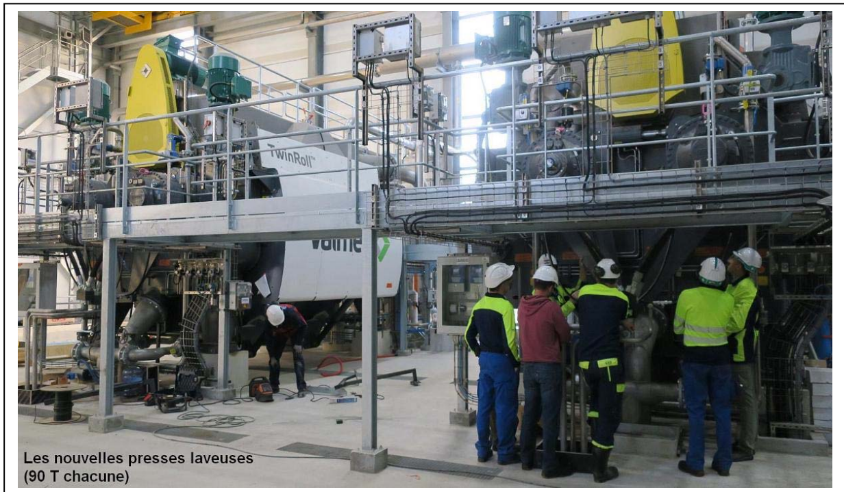
Les nouvelles presses de lavage
