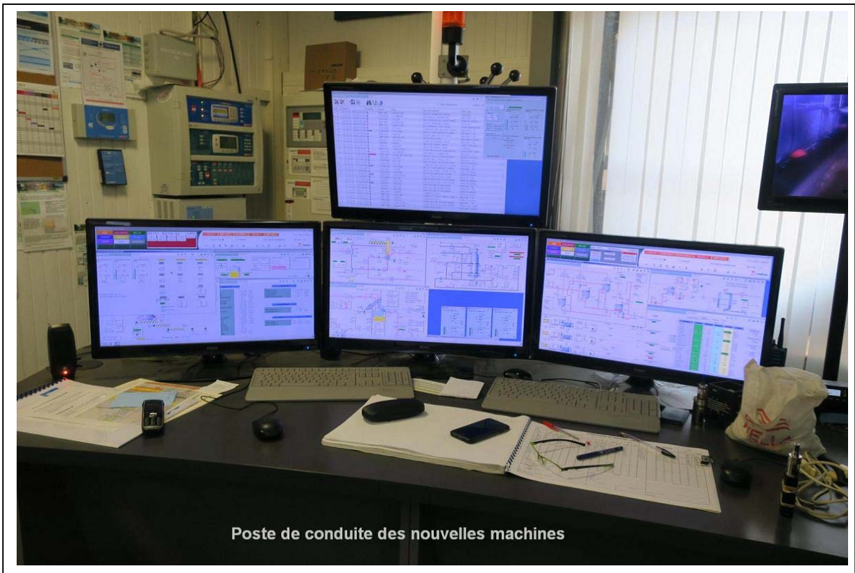
Salle de contrôle – poste de conduite des presses et des épurateurs
